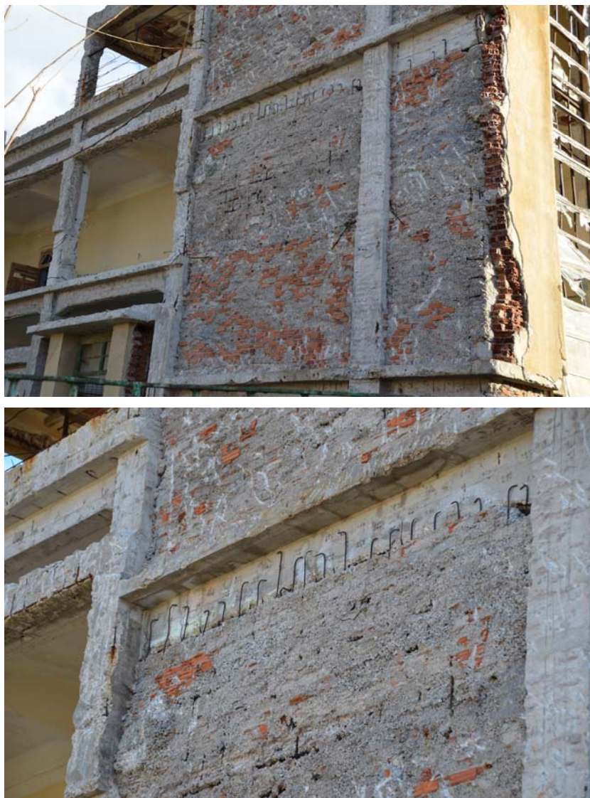
Εικόνα 5.4: Εικόνες τοιχοπλήρωσης, όπως κατασκευάστηκε στο Ληξούρι κατά τη δεκαετία του 1960. Το κτίριο βρισκόταν σε διαδικασία ανακαίνισης, κατά το σεισμό της 26 ης Ιανουαρίου 2014. Οι φωτογραφίες ελήφθησαν αμέσως μετά το σεισμό.
